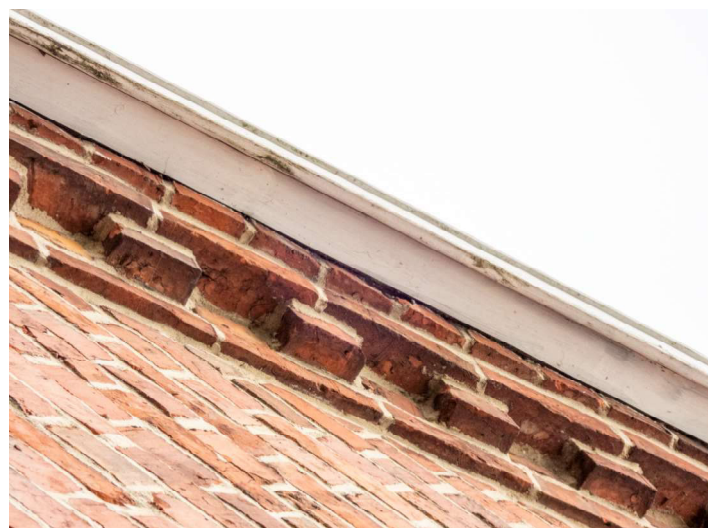
Weitere Spalten bieten Zugang zum Dachboden. (Foto: DSCN0010)
