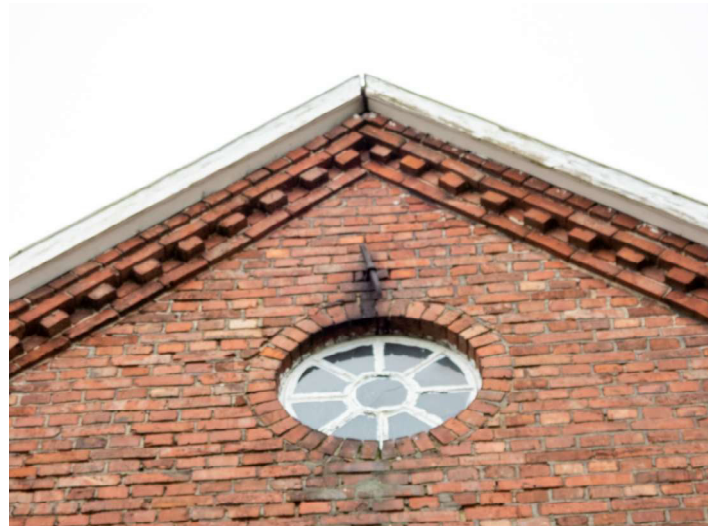
Spalt im Giebel auf Westseite bietet Zugang zum Dachbod
