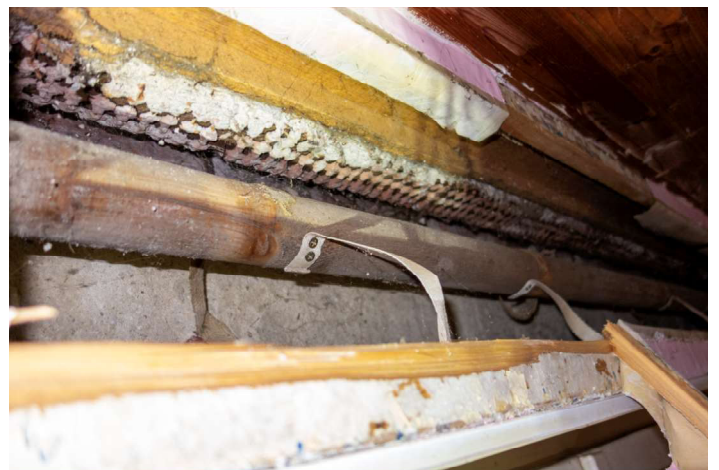
Geöffneter Rollladenkasten. (Foto: _DSC5062)
