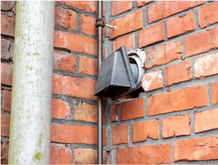
Spalt ins Mauerwerk. (Foto: DSCN0024)
