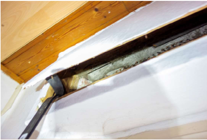
Geöffneter Rollladenkasten. (Foto: _DSC5059)
