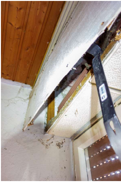
Geöffneter Rollladenkasten. (Foto: _DSC5063)
