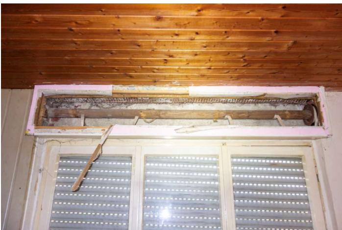
Geöffneter Rollladenkasten. (Foto: _DSC5061)
