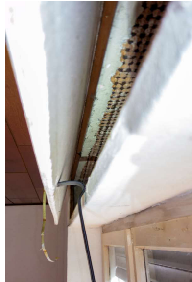
Geöffneter Rollladenkasten. (Foto: _DSC5060)
